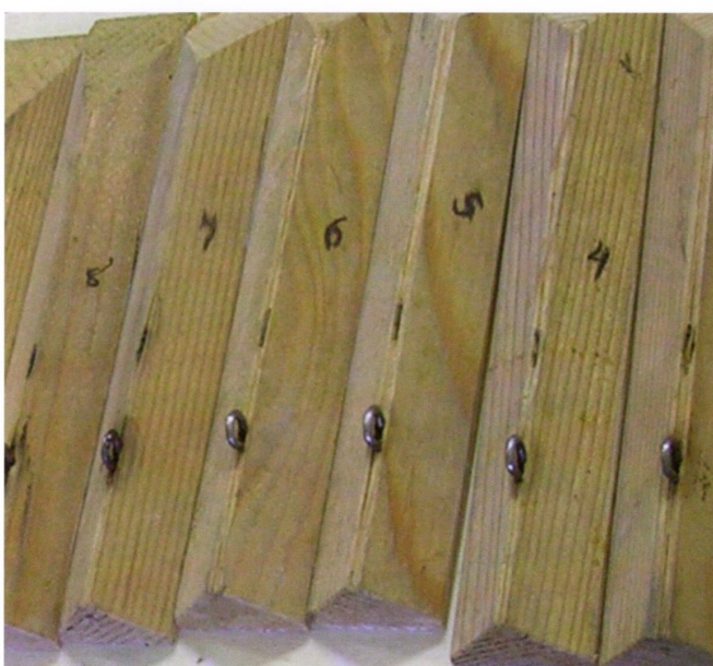
I ventilabris d'abete predisposti per l'intervento: in primo piano la numerazione a penna originale e gli occhielli in ferro per l'aggancio dei tiranti
