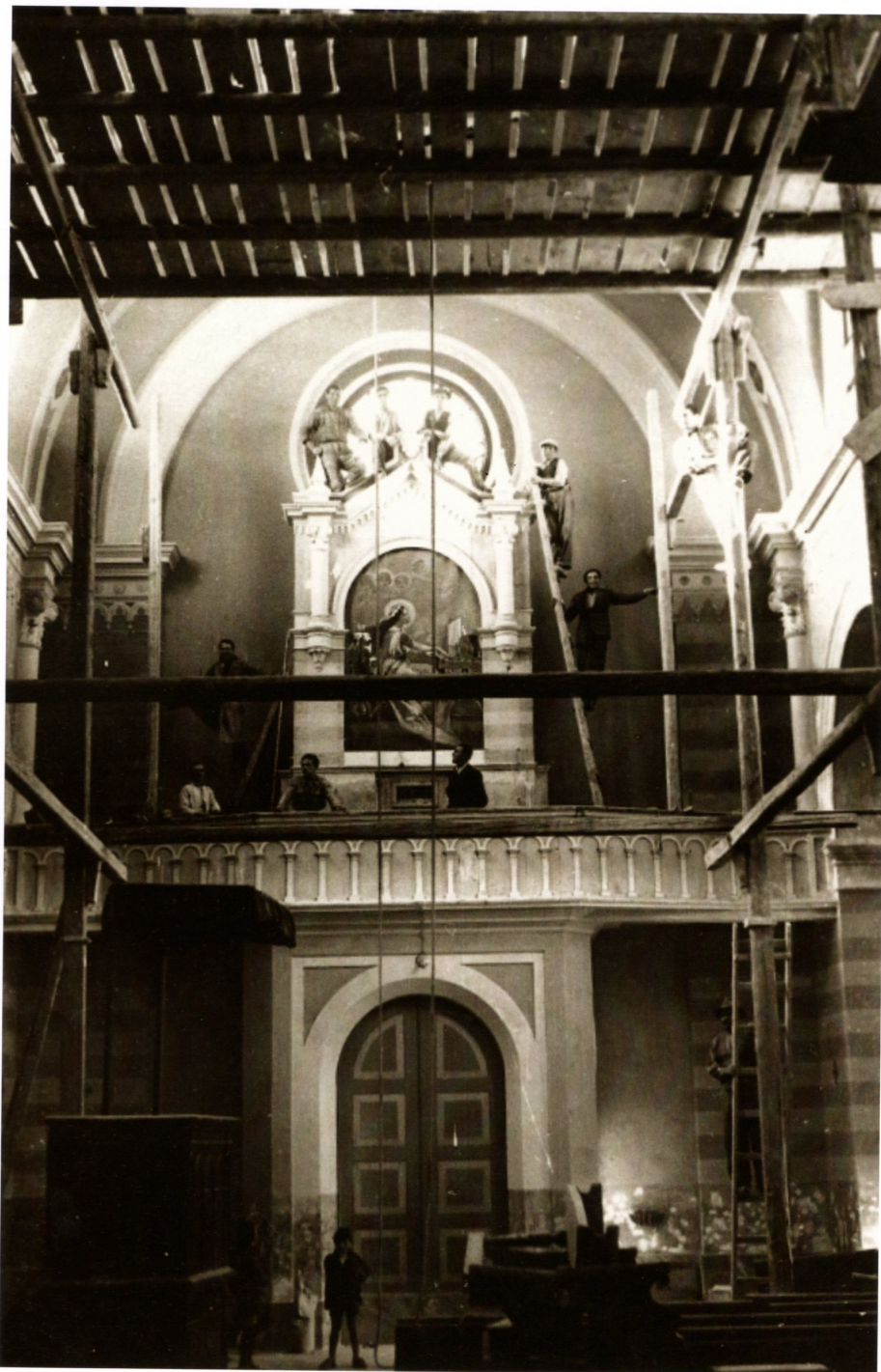
Riproduzione dell'interno della chiesa di Santa Maria durante i lavori effettuati nel marzo 1937
