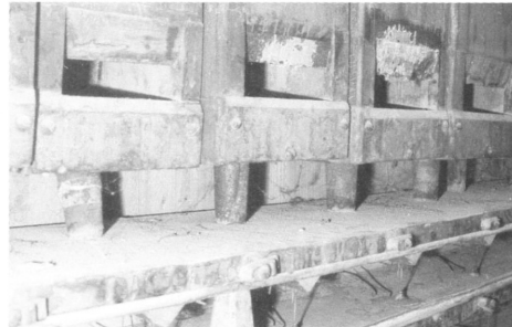
Le canne di legno e il somiere secondario prima dell'intervento: evidenti e diffuse le tracce di umidità
