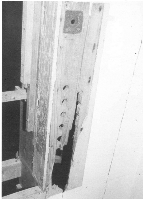
La parte della cassa, in corrispondenza della tavola dei registri, danneggiata dalla scheggia
